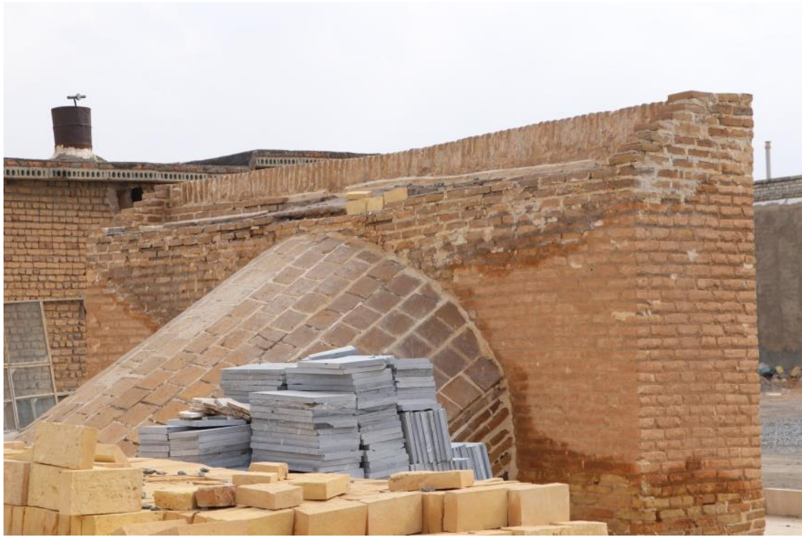
وجود رطوبت نزولی بر روی بام بخش ورودی آب انبار
